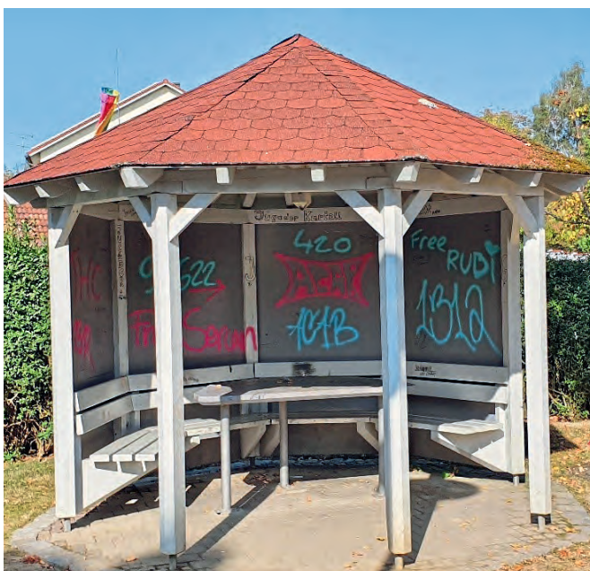
Beschmierter Pavillion in der Lindenstraße
