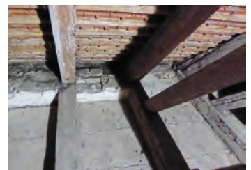
Mauerlatte ohne Hinterlüftung
